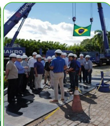
Visita à manutenção
